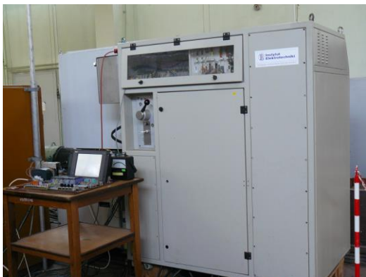
Rys. 1. Stanowisko do badań układów napędowych 3000 V DC.
