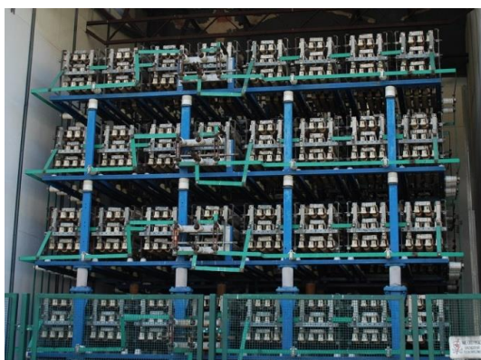
Rys. 3. Opornica zewnętrzna o mocy 2.5 MVA.
